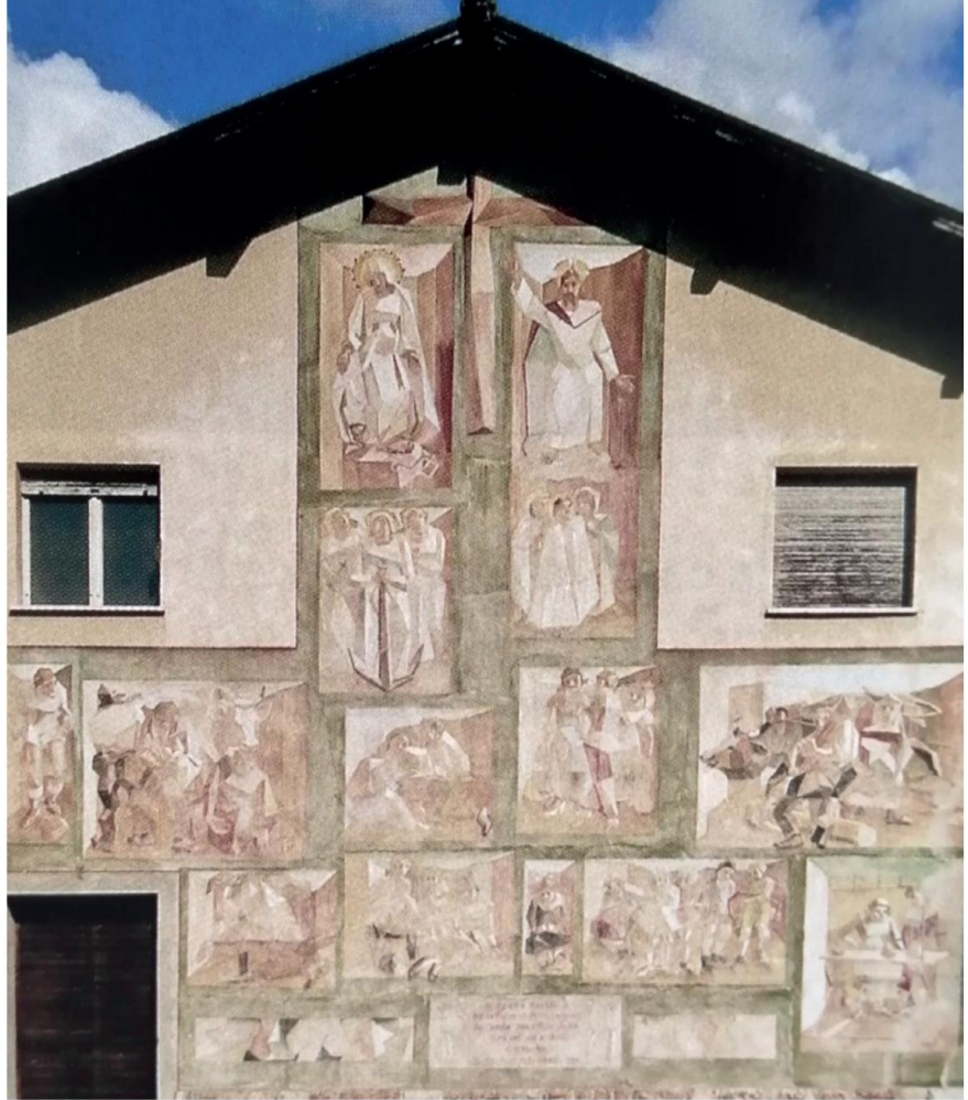
El fresco de la fachada occidental de la antigua "casa social" de Godenzo, antes y después de la restauración
